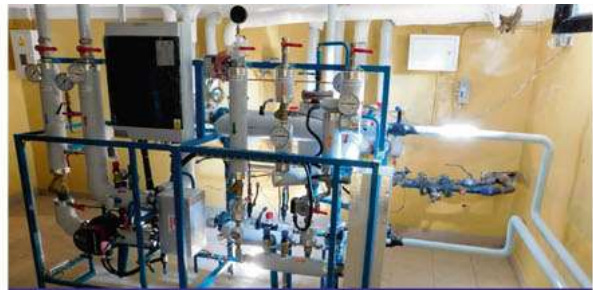
Wężły ciepłne dwufunkcyjne w zasobach Al. Wojska Polskiego do podłączenia ciepłej wody użytkowej i likwidacji piecyków gazowych
